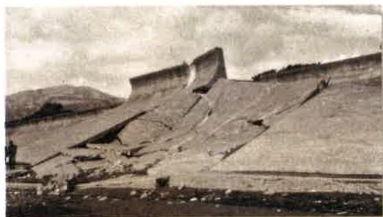
蒲原海岸堤防の被災状況
