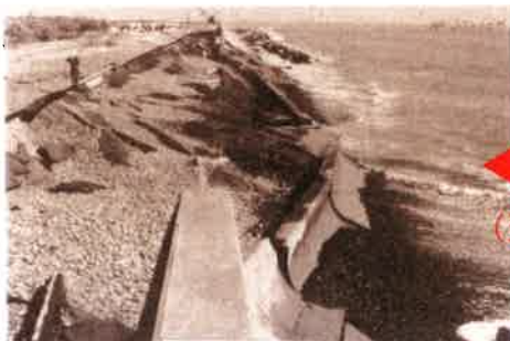
●S47. 10. 31 破堤後の状況
