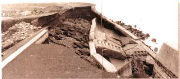
S47. 7. 23 台風9号による川尻工区の破堤状況
